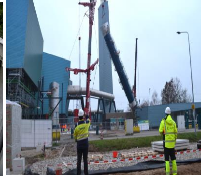
TWENCE CCU – Just Catch 100 KTPA TWENCE W2E
